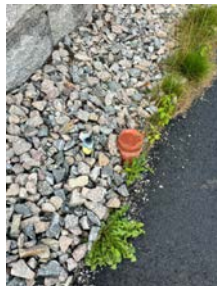
Utvendig spylepunkt for avløpsanlegget.
