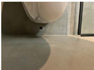
Drensåpning for innbygget toalettsisterne.
