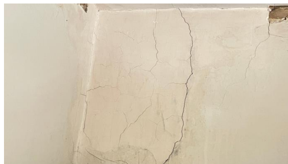
Sprekker i skorstein på kjøkken.
