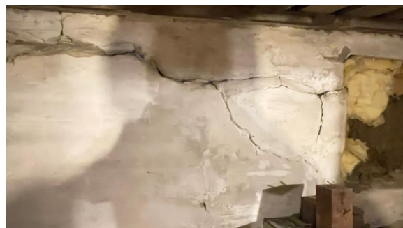
Sprekker i grunnmur.
