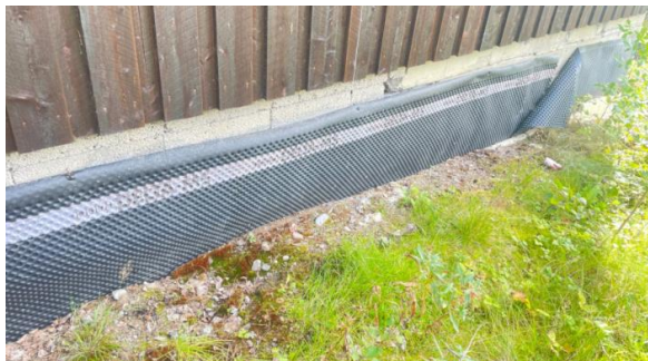
Manglende topplist på mangelfull innfestet grunnmurplast.
