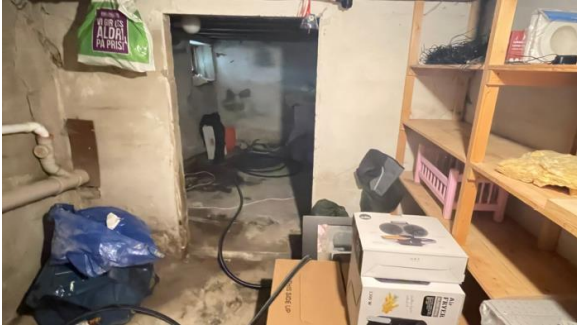
Fuktig gulv i opprinnelig del av kjeller.
