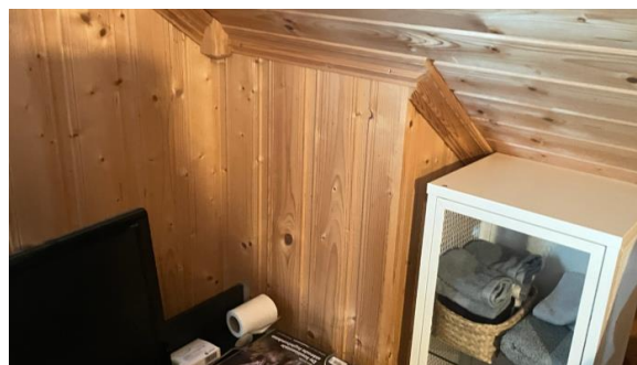
Innkledd elementskorstein på soverom.
