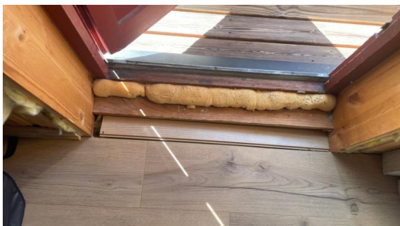
Uferdig laminatgulv ved balkongdør.
