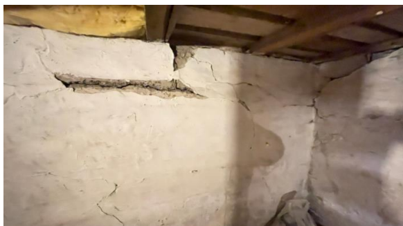
Sprekker i grunnmur.
