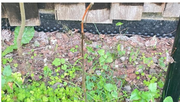
Uferdig avretting av kledningsbord ved grunnmur.
