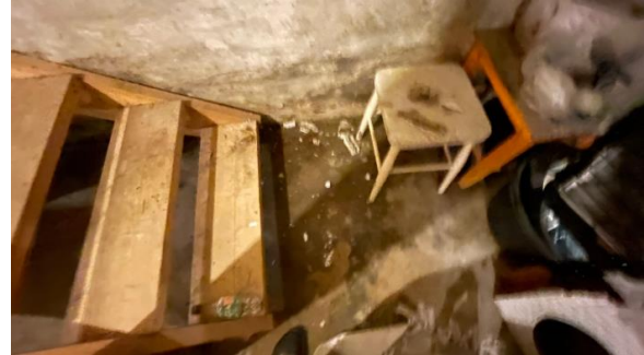
Fuktig gulv i opprinnelig del av kjeller.
