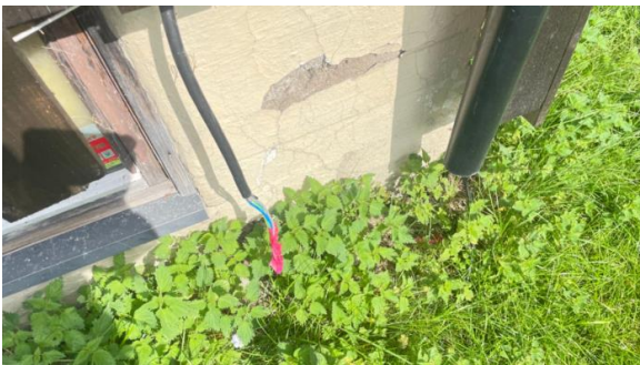
Løse ledningsende uten endesikring.
