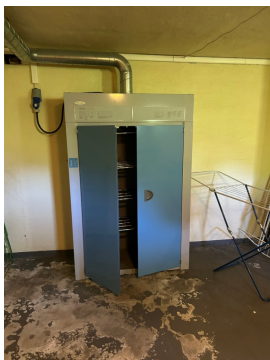
Felles vaskeri/tørkeskap i kjeller.
