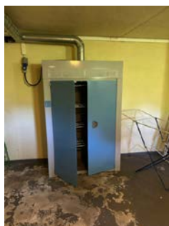
Felles vaskeri/tørkeskap i kjeller.
