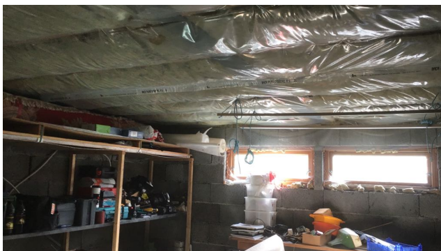
Uferdig rom i kjelleren
