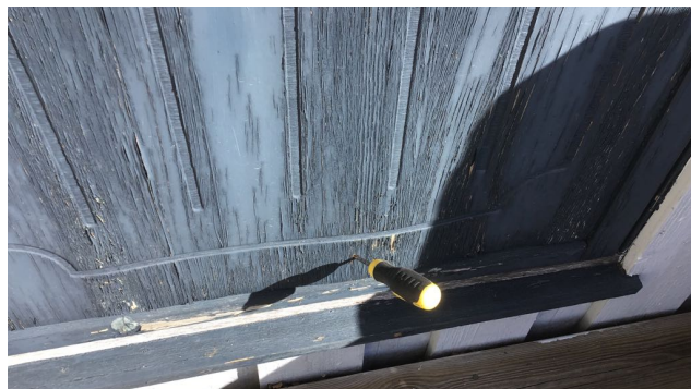
Fukt svelling i nedkant balkongdør i fra stue
