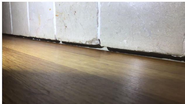
Utett fuge mellom kjøkkenbenk og fliser
