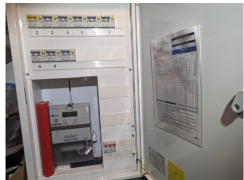
Innmat i sikringsskap
