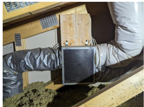
Avtrekksvifte på loft
