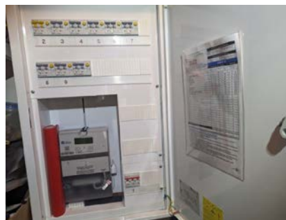
Innmat i sikringssskap
