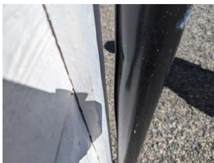
Taknedløp med frostspreng
