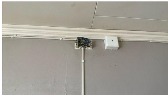
Koblingsboks mangler deksel og må utbedres.
