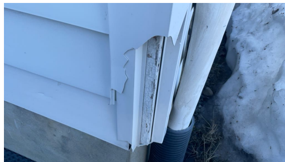
Skader i plastkledning.
