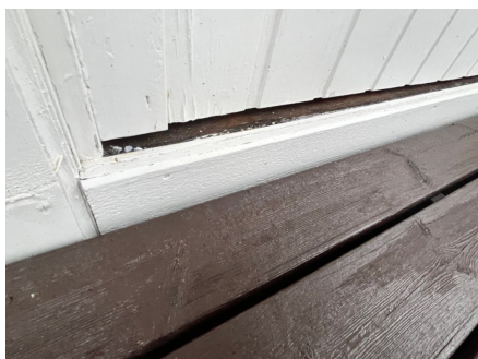
Mangler beslag under dør
