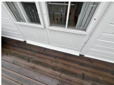
Kledning helt ned mot gulv
