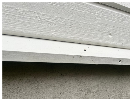
Ikke luftespalte i nedkant på vegg
