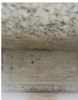
Ikke luftespalte i nedkant på vegg
