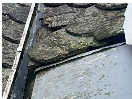
Ugunstig løsning, vann kan lett drive inn under tekkingen.
