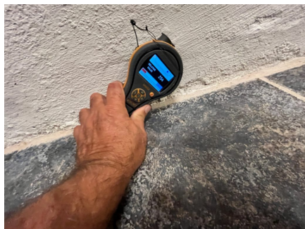
Målt på vegg i bod
