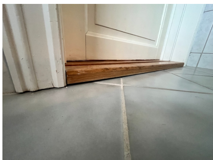
Ukjent oppkant under dør.
