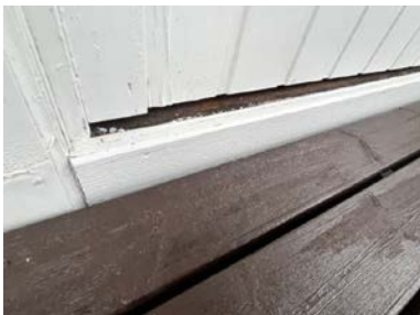
Mangler beslag under dør
