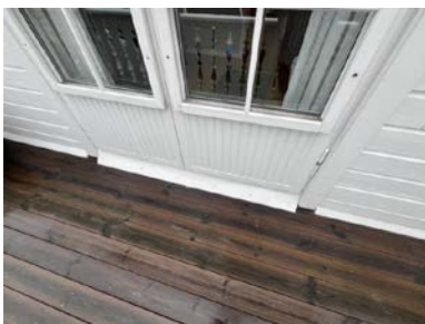
Kledning helt ned mot gulv
