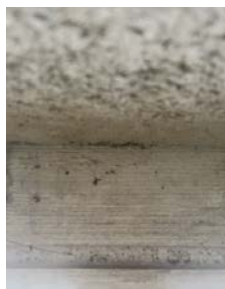
Ikke luftespalte i nedkant på vegg
