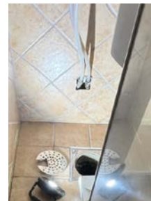
Åpning i vegg bak dusjkabinett
