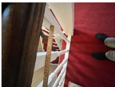
Åpninger i rekkverk trapp til 2 etasje
