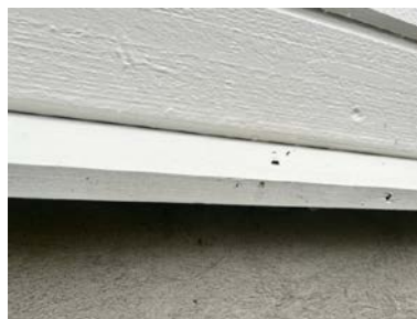
Ikke luftespalte i nedkant på vegg
