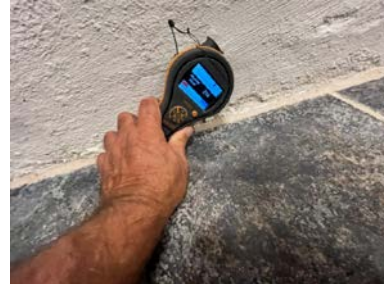
Målt på vegg i bod
