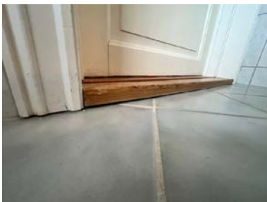
Ukjent oppkant under dør.
