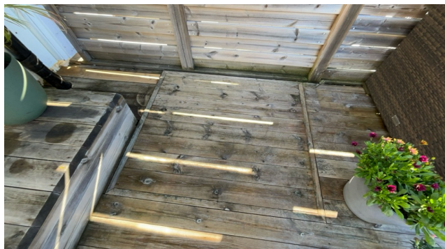
Drenskum er plassert under terrassen.
