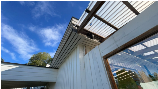
Synlige luftespalter i gesimskasser.
