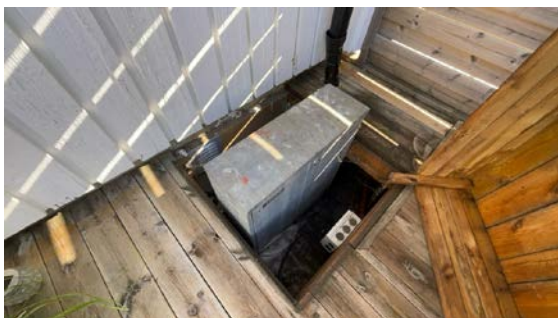
Inntaksboks plassert under terrassen.
