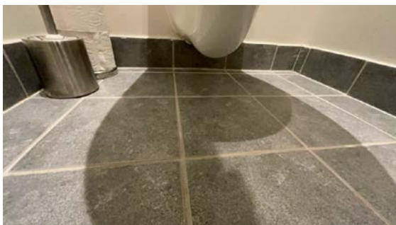
Luftespalte på dørblad bør opparbeides.
