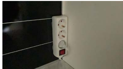
Løsning med skjøteledning montert på kjøkkenbenk er ikke å anbefale. Tiltak må påregnes.
