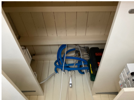
Samlestokk for rør i rør opplegg i bod i entre.
