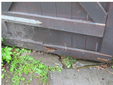
Råteskade på dør i utebod.
