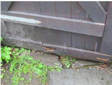
Råteskade på dør i utebod.
