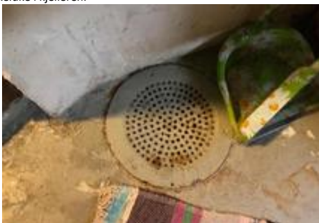
Sluk i støpejern i kjelleren.
