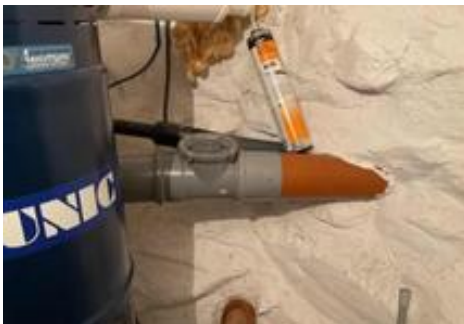
Stakeluke i kjelleren.
