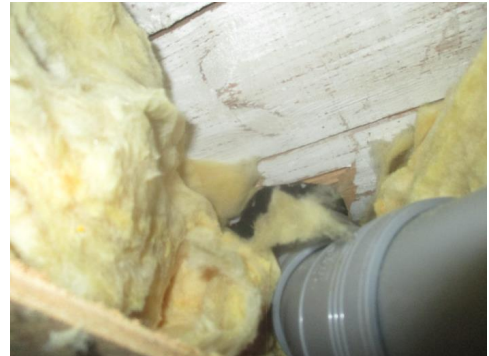
Fuktmåling i underliggende himling nær sluk.
