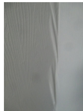
Tapet har bølget seg noe i hjørner.
