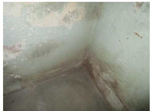
En del fuktvandring i grunnmur.
