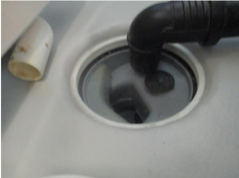
Sluk ved dusjkabinett.
