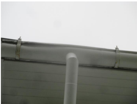
Eldre takrenner i mot vei.
