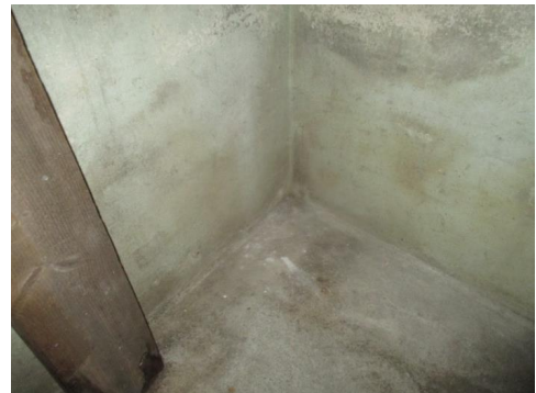
Fuktmerker og noe salutslag.
