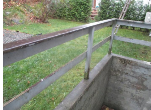
Store åpninger i rekkverk.
