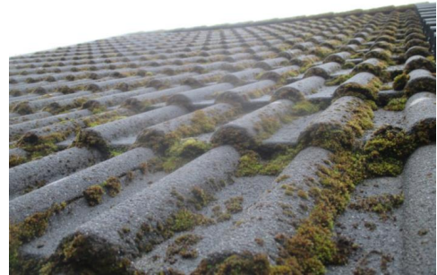
Deler av taktekingen på baksiden av boligen.
