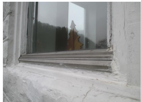
Slitte/skadet på utvendig karm og ramme.
