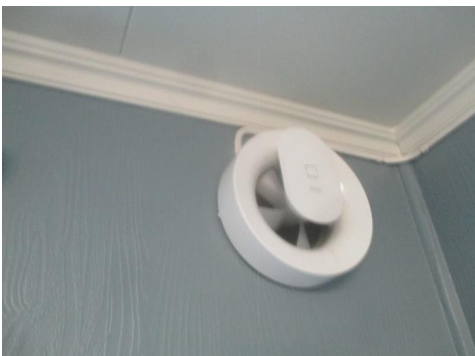
Vifte i ytterveggen.
