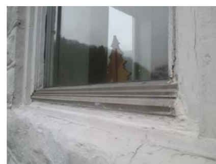
Slitte/skadet på utvendig karm og ramme.
