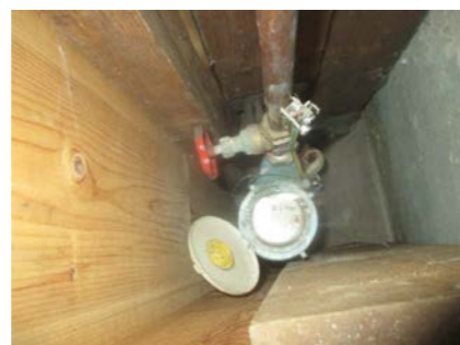
Innvendig stoppekran med vannmåler i grovkjeller.
