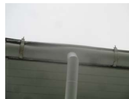
Eldre takrenner i mot vei.
