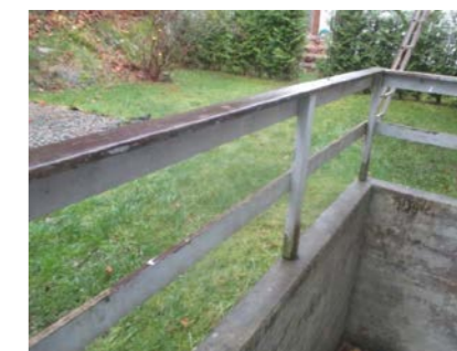
Store åpninger i rekkeverk.
