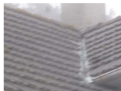
Deler av taktekkingen i mot vei.
