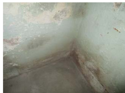
En del fuktvandring i grunnmur.
