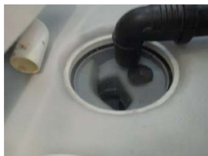
Sluk ved dusjkabinett.
