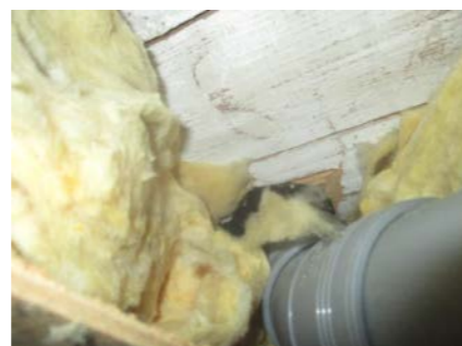
Fuktmåling i underliggende himling nær sluk.
