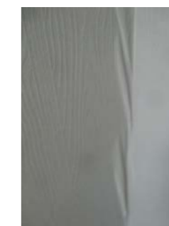
Tapet har bølget seg noe i hjørner.
