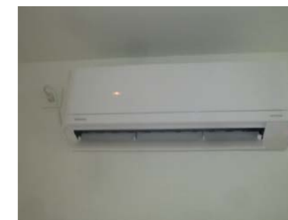
Varmepumpe i stue.
