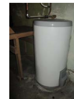
Bereder er plassert i grovkjeller.
