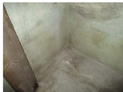
Fuktmerker og noe salutslag.
