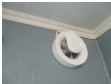
Vifte i ytterveggen.
