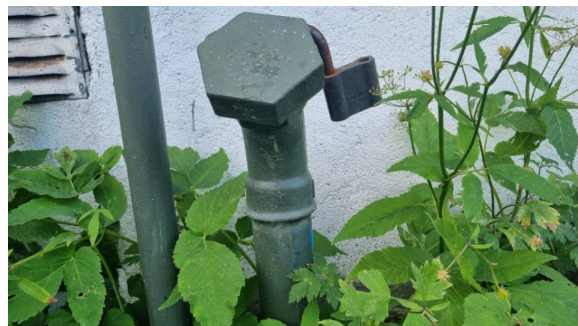
Påfyllingsrør til oljetanken
