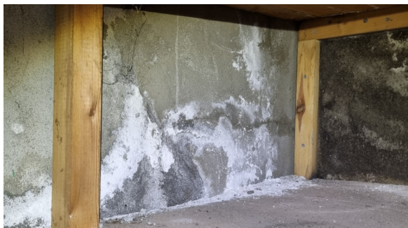
Soppvekst og saltutslag i kjeller.
