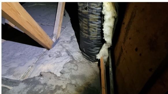
Fuktmerker på isolasjon under luftehatt.
