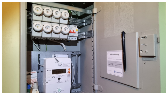
Kontroll av el-skapet i tilbygget del. Manglende kursfortegnelse her.
