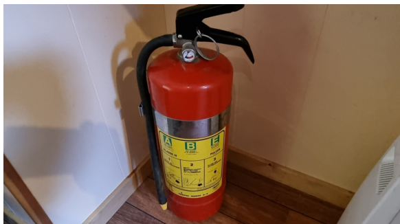
Brannslukningsapparat av eldre dato.
