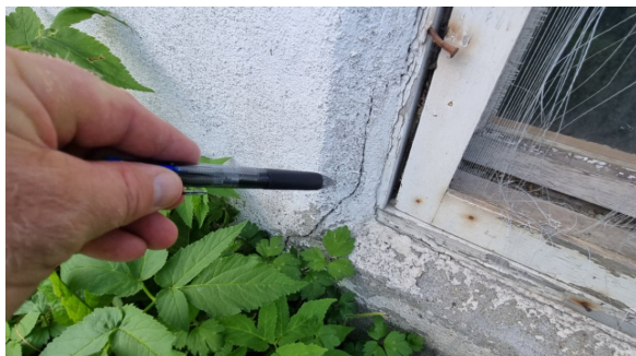
Sprekker i grunnmur.
