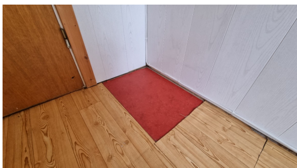
Delvis manglende belegget i det ene soverommet.
