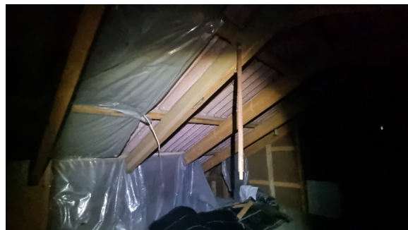
Det er stedvis plast på kaldloftet. Plasten bør fjernes da dette kan føre til kondens.
