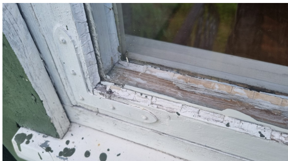
Vinduer er slitte.
