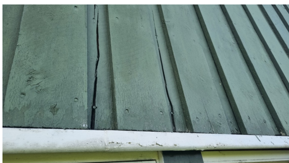
Sprekker i kledningen.
