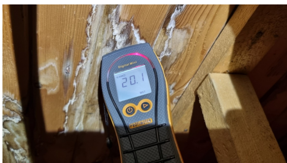
Fuktmåling i fuktmerker, forhøyede fuktverdier ble registrert
