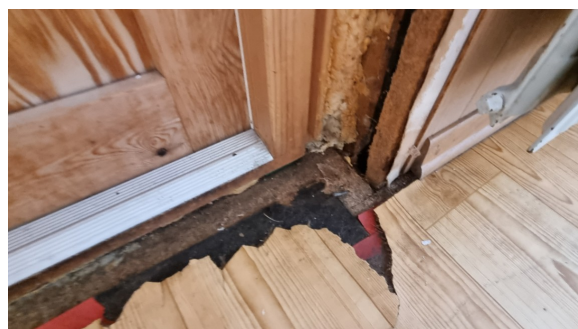
Sår og skader i belegget.
