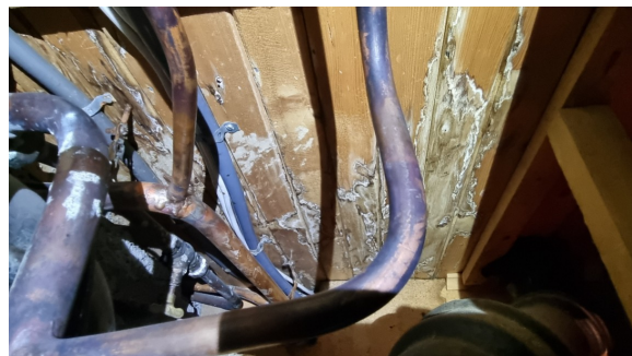
Fuktmerker og soppvekst opp under stubbloft.
