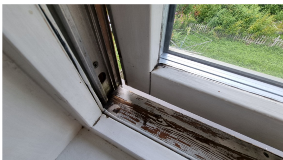
Vinduer har svekkelser.
