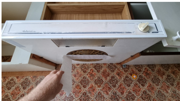
Funksjonstesting av det mekaniske avtrekket
