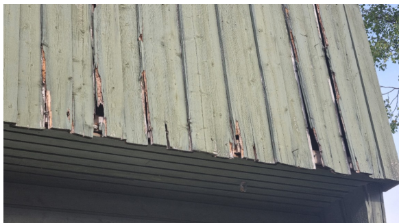
Råteskader i ytterkledningen.
