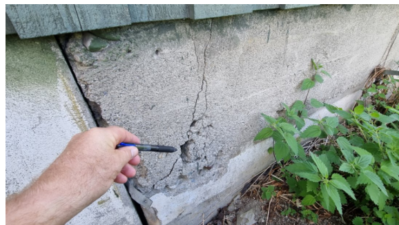
Sprekker i grunnmur.
