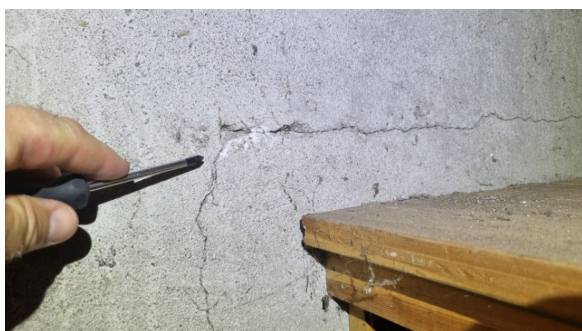
Sprekker i grunnmur.
