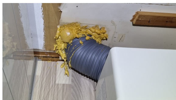
U fagmessig gjennomføring av ventilasjonskanal i himling.
