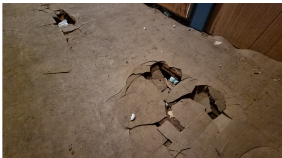
Råteskader i kjeller.
