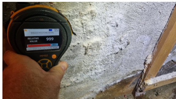
Fuktmåling i kjeller, forhøyede fuktverdier ble registrert
