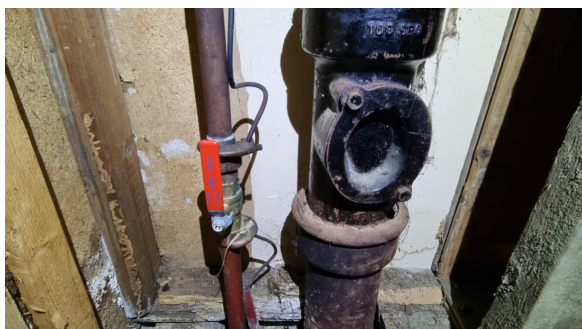
Kontroll av innvendig hovedstoppekran.
