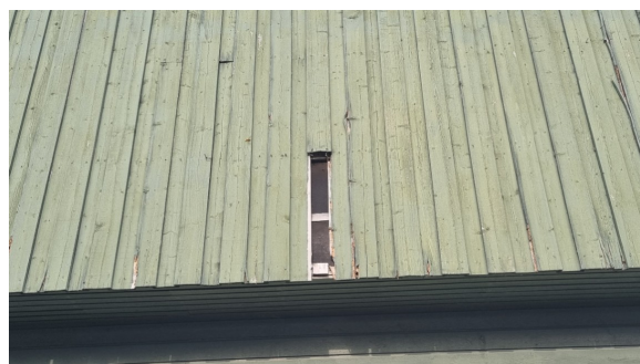
Manglende kledningsbor fasade vest.
