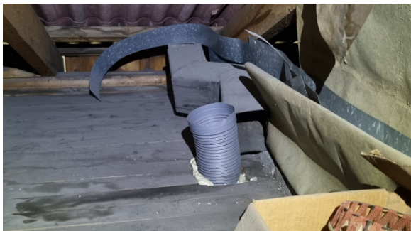
Ventilasjonskanal er kun ledet til kaldloftet.
