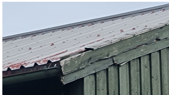
Råteskader i vindskibord.
