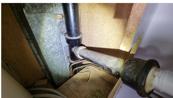
Avløp av soilrør fra byggeår.
