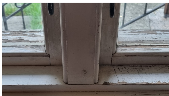
Vinduer har svekkelser.
