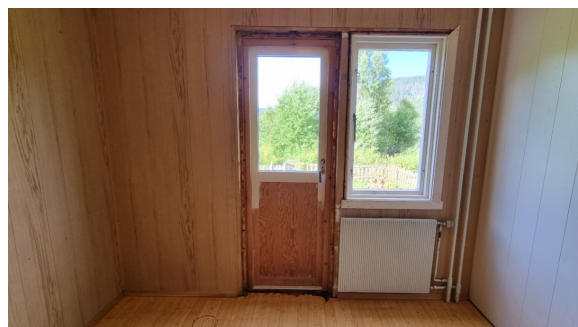
Terrassedør i 1. etasje mangler innvendige utføringer og lister.
