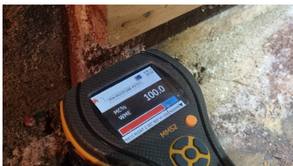
Fuktmåling i kjeller, forhøyede fuktverdier ble registrert.
