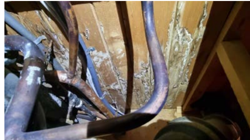
Fuktmerker og soppvekst opp under stubbloft.
