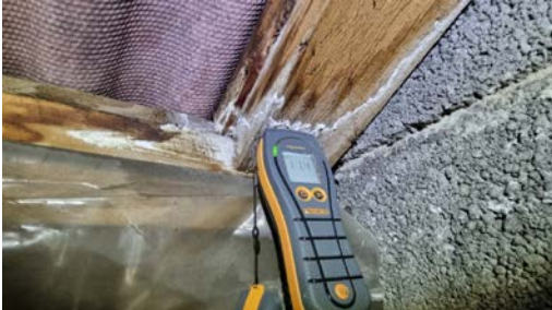
Soppvekst og fuktmerker ved pipen. Det ble fuktmålt her ved befaring, ingen unormale fuktverdier ble registrert.
