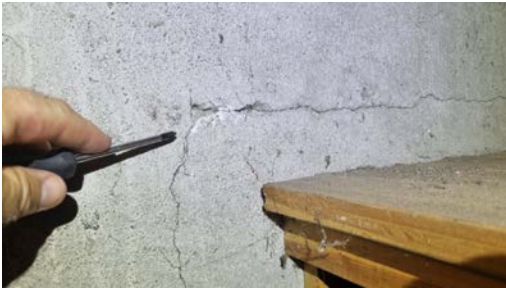
Sprekker i grunnmur.
