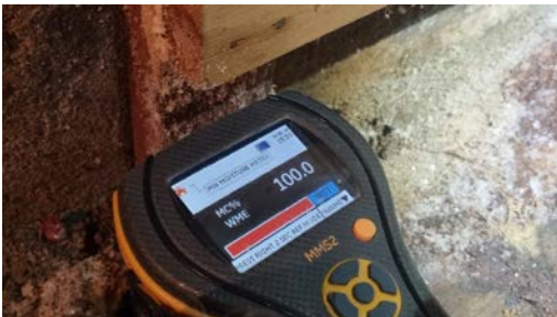
Fuktmåling i kjeller, forhøyede fuktverdier ble registrert.
