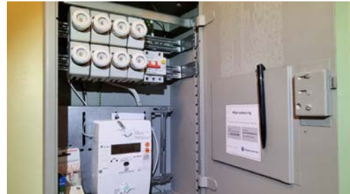
Kontroll av el-skapet i tilbygget del. Manglende kursfortegnelse her.
