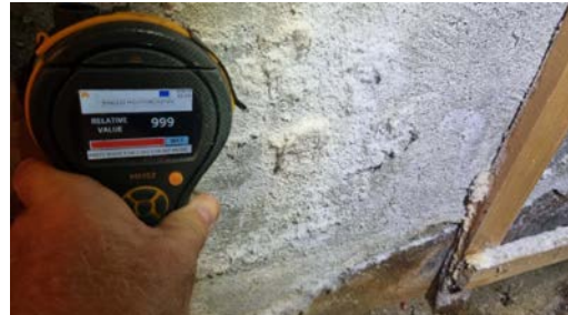
Fuktmåling i kjeller, forhøyede fuktverdier ble registrert
