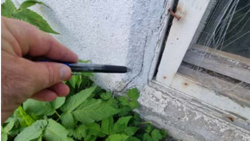
Sprekker i grunnmur.
