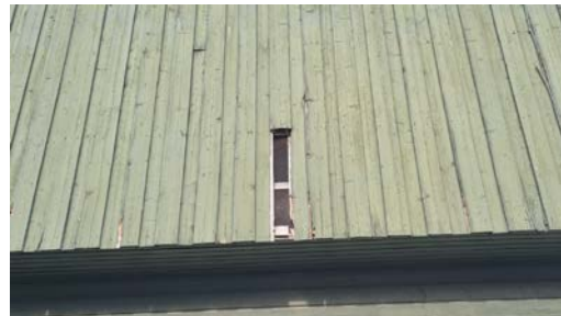
Manglende kledningsbor fasade vest.
