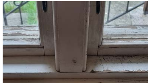
Vinduer har svekkelser.
