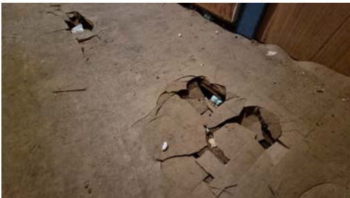
Råteskader i kjeller.
