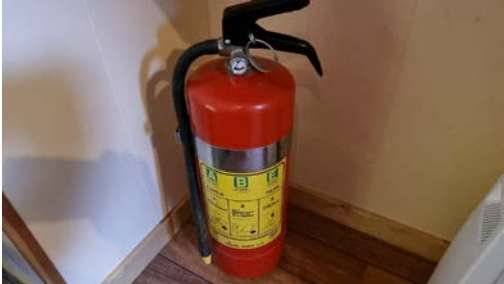
Brannslukningsapparat av eldre dato.
