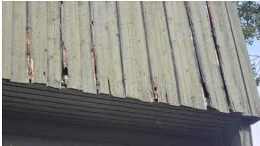
Råteskader i ytterkledningen.
