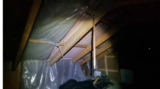
Det er stedvis plast på kaldloftet. Plasten bør fjernes da dette kan føre til kondens.
