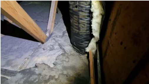
Fuktmerker på isolasjon under luftehett.
