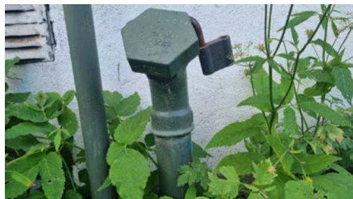
Påfyllingsrør til oljetanken
