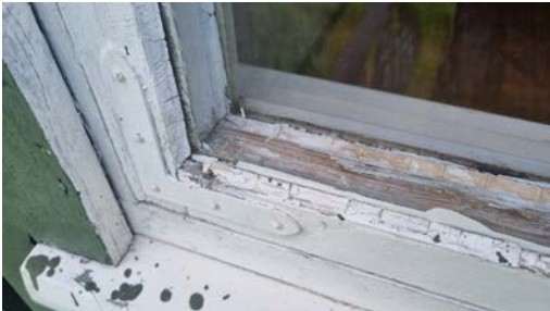
Vinduer er slitte.
