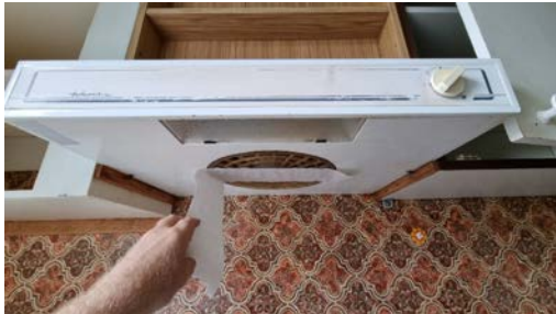
Funksjonstesting av det mekaniske avtrekket
