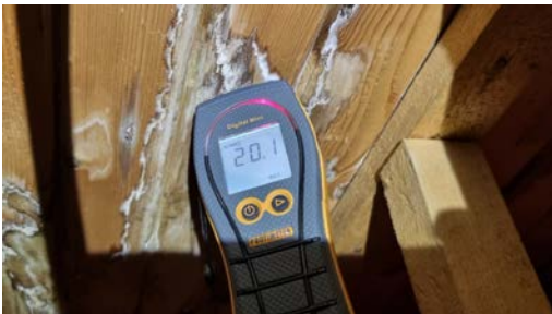
Fuktmåling i fuktmerker, forhøyede fuktverdier ble registrert
