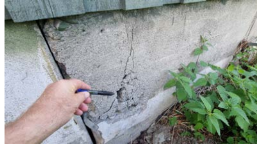
Sprekker i grunnmur.
