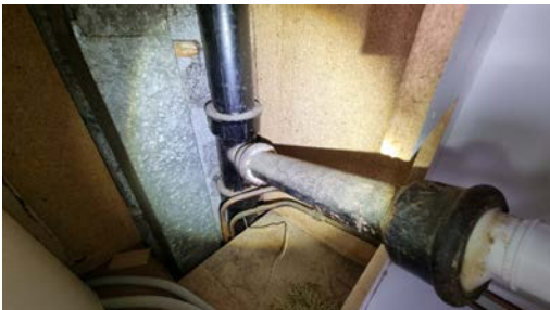
Avløp av soilrør fra byggeår.
