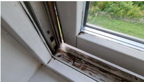
Vinduer har svekkelser.
