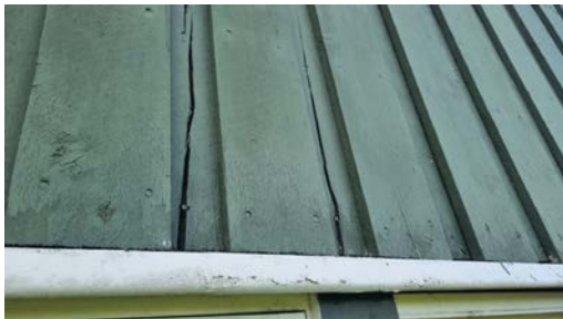
Sprekker i kledningen.
