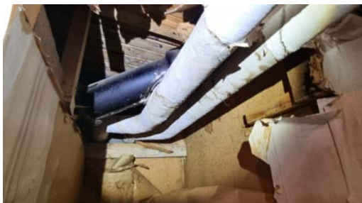
Usikkerhet om isolasjon på rør i kjeller inneholder asbest
