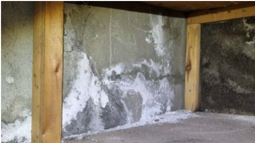
Soppvekst og saltutslag i kjeller.
