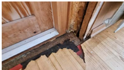
Sår og skader i belegg.
