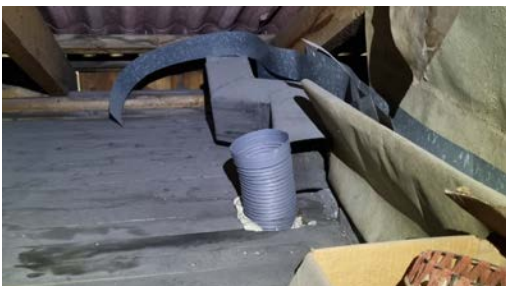
Ventilasjonskanal er kun ledet til kaldloftet.
