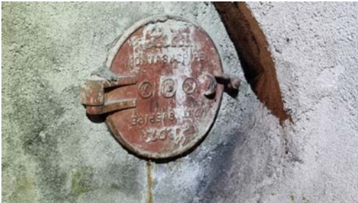
Sotluke i kjeller.
