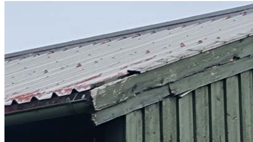
Råteskader i vindskebord.
