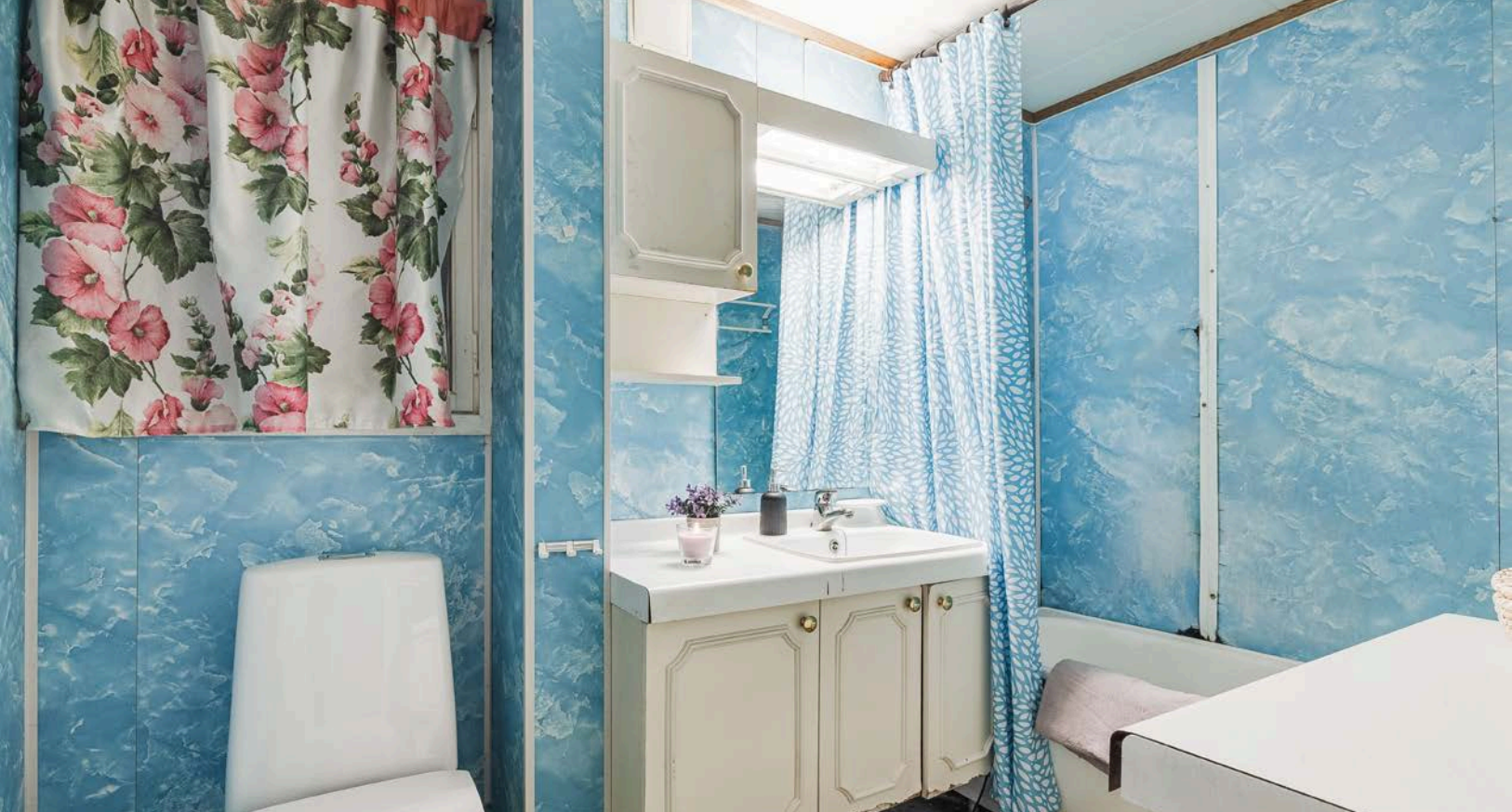
Eldre badrom som må oppgraderes for å tåle normal bruk etter dagens krav. Badrommet har våtromsbelegg på gulv og våtromsplater på veggene.
