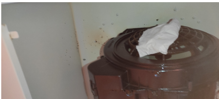
Funksjonstest av ventilator.
