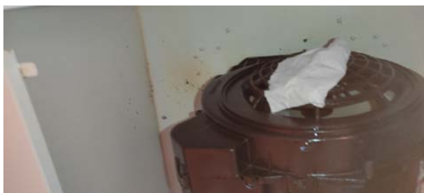
Funksjonstest av ventilator.
