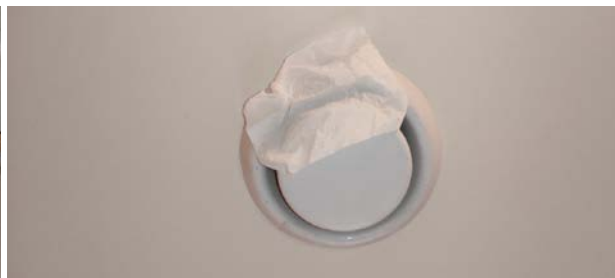
Funksjonstest av avtrekk.
