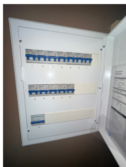
Sikringskap med automatsikringer.
