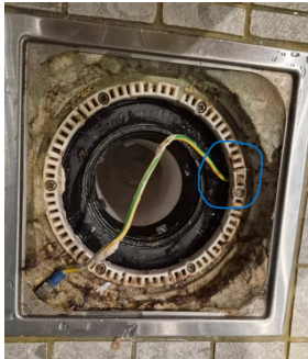
Plastsluk med jordledning i klem
