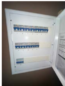
Sikringsskap med automatsikringer.
