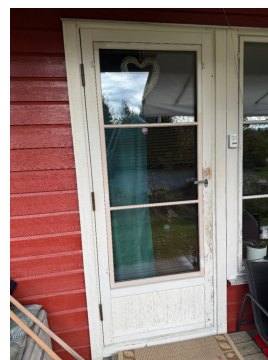
Terrassedør med vedlikeholdsbehov.
