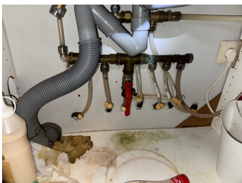
Pågående lekkasje på rørapplegg i kjøkkenbenk.
