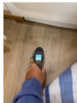
Forhøyede indikasjoner på fukt under laminatgulv
