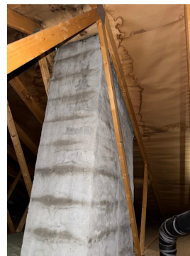
Gamle fuktmerker ved pipegjennomføring
