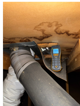
Gamle fuktmerker og utett gjennomføring ved luftehatt
