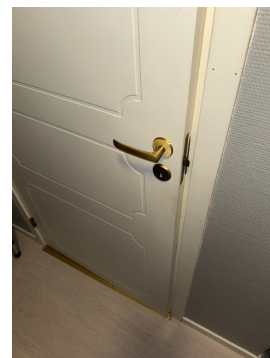
Dørblad tar i terskel og karm til bod i leilighet 8.
