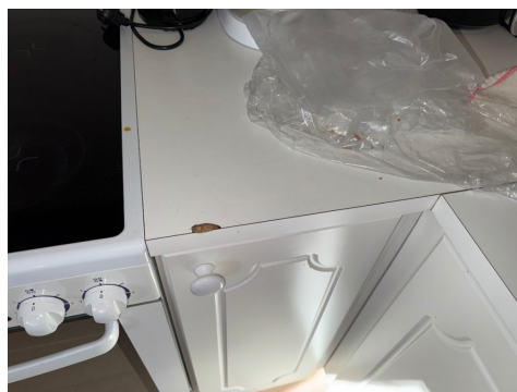
Skade i benkeplate
