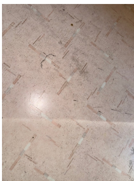
Skader/hull og misfarget i gulvbelegg fra byggeår.
