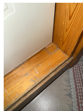
Dørblad subber i terskel til bad i leilighet 10.
