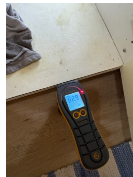
Fuktskadede bunnplate i kjøkkenbenk
