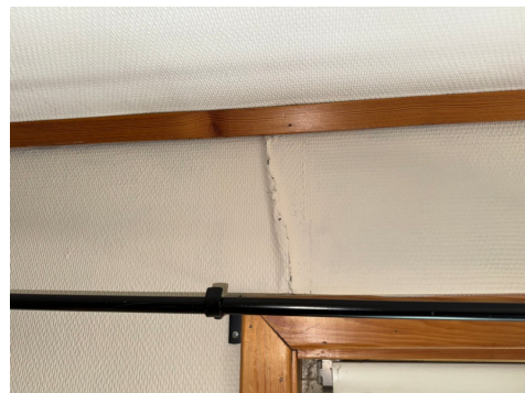
Sprekker i plateskjøter/malt strie
