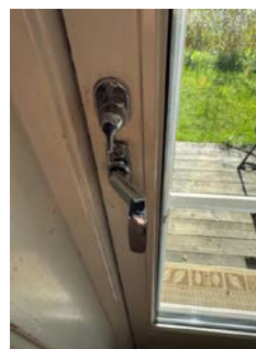
Terrassedør med forhøyetslitasje på vridere (nr. 8)
