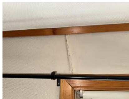
Sprekker i plateskjøter/malt strie
