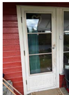
Terrassedør med vedlikeholdsbehov.
