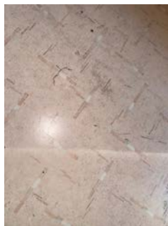
Skader/hull og misfarget i gulvbelegg fra byggeår.
