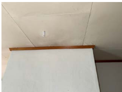
Skader i tak ess plater/folie
