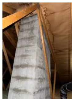
Gamle fuktmerker ved pipegjennomføring
