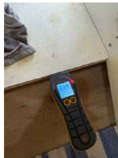
Fuktskadet bunnplate i kjøkkenbenk
