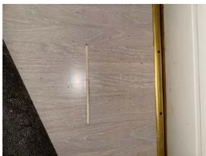
Laminatgulv med større sprekke i skjøt.
