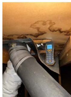
Gamle fuktmerker og utett gjennomføring ved luftehatt
