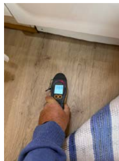
Forhøyede indikasjoner på fukt under laminatgulv
