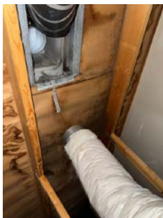
Ventilasjonskanal ikke tilkoblet utluftingshatt
