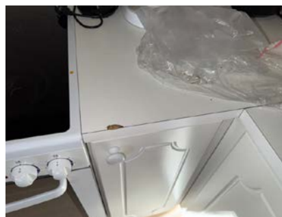
Skade i benkeplate
