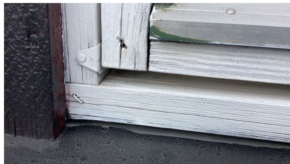
Eksempel på værslitt vindu.
