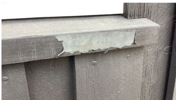
Slitasje på vannbrettbeslag.
