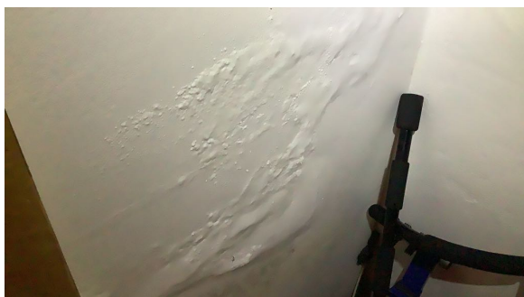
Eksempel på saltutslag på murvegg.
