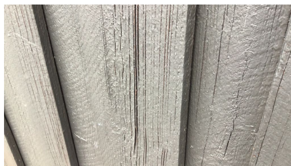
Eksempel på oppsprukket kledning.
