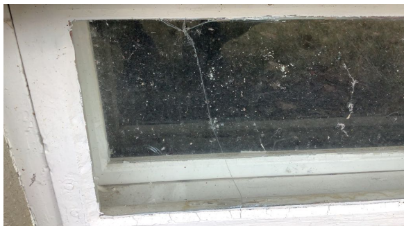
Sprukket glass i vindu.
