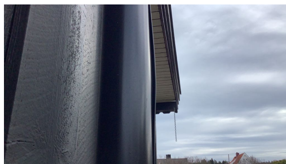
Eksempel på frostsprengt nedløpsrør.
