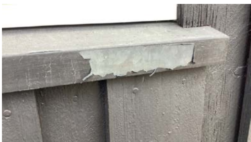
Slitasje på vannbrettbeslag.
