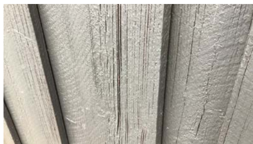
Eksempel på oppsprukket kledning.
