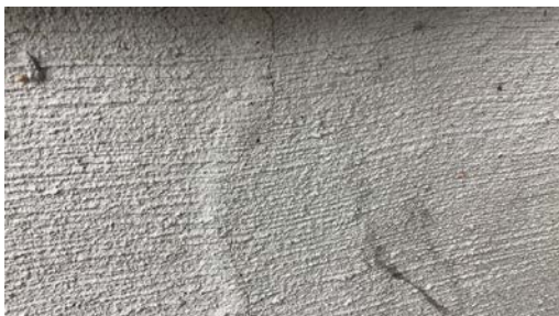
Eksempel på utvendig skråriss.
