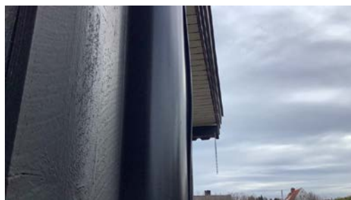
Eksempel på frostsprengt nedløpsrør.
