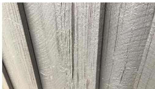
Eksempel på oppsprukket kledning.
