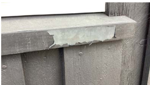
Slitasje på vannbrettbeslag.
