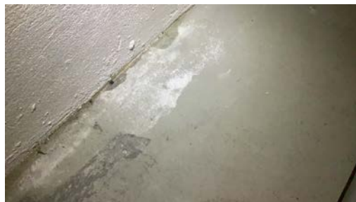
Eksempel på saltutslag på betonggulv.
