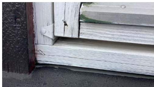
Eksempel på værslitt vindu.
