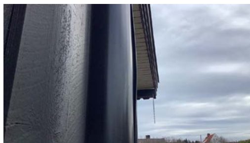
Eksempel på frostsprengt nedløpsrør.
