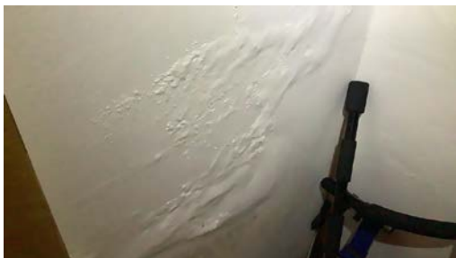
Eksempel på saltutslag på murvegg.
