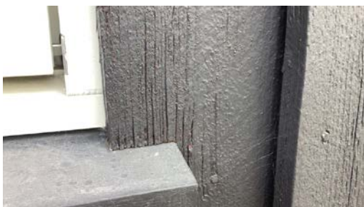
Omrømming er ført helt ned til vannbrett.
