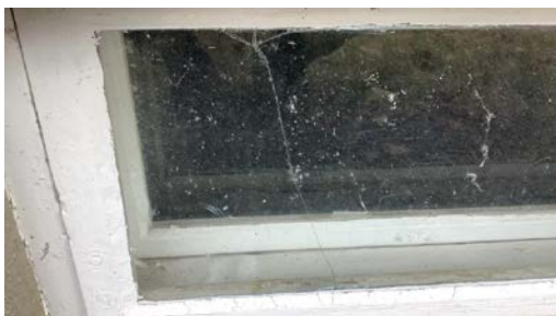
Sprukket glass i vindu.
