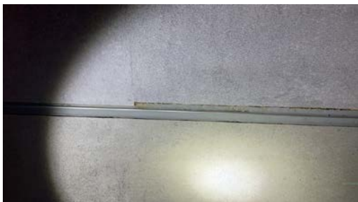
Dårlig vedheft av silikon mellom bunnlist og baderomsplate i dusjsone.
