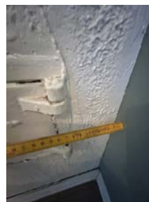
Feieluke plassert for nærme brennbart materiale.
