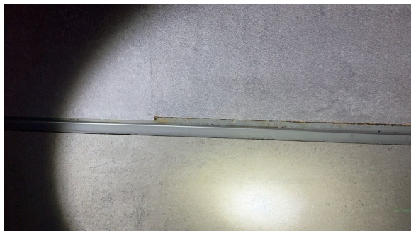
Dårlig vedheft av silikon mellom bunnlist og baderomsplate i dusjsone.
