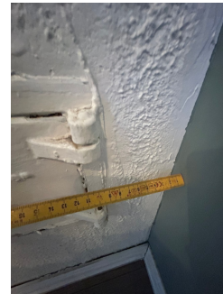
Feieluke plassert for nærme brennbart materiale.
