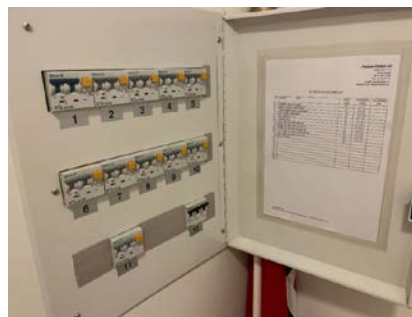
Sikringsskap i bod.
