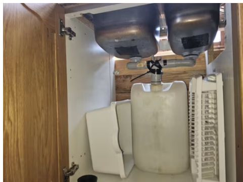
Bilde viser røropplegg under oppvaskkum på kjøkken.
