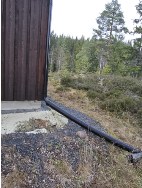
Bilde viser bortledning av takvann.
