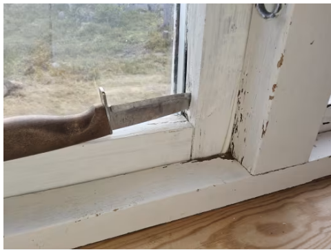
Bilde viser råteskadet vindu.
