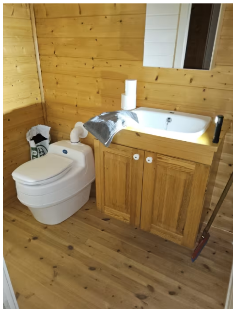
Bilde viser installasjoner på toalettrom.
