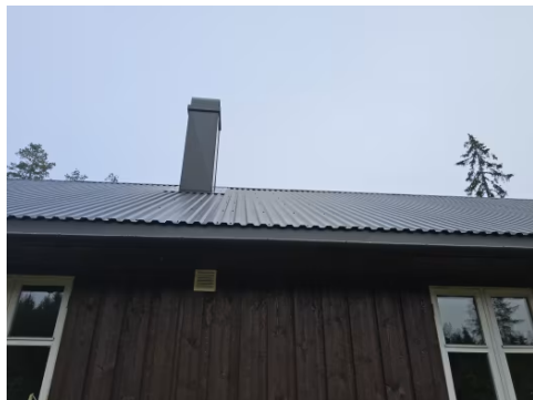
Bilde viser manglende takstige for feier.
