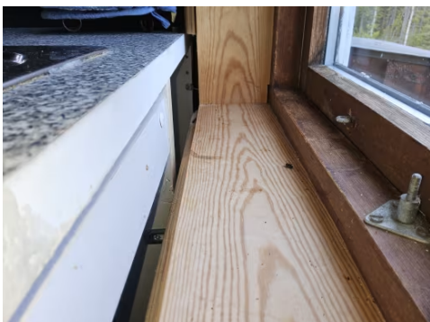
Bilde viser ufagmessig utførelse på kjøkken.
