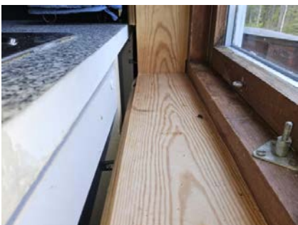
Bilde viser ufagmessig utførelse på kjøkken.
