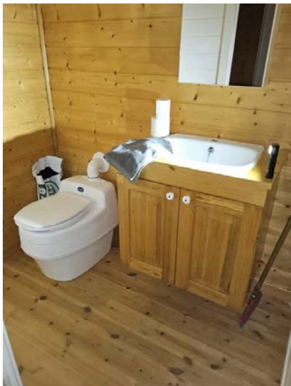
Bilde viser installasjoner på toalettrom.
