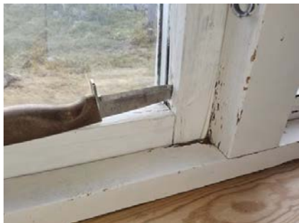
Bilde viser råteskadet vindu.
