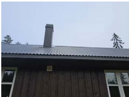
Bilde viser manglende takstige for feier.
