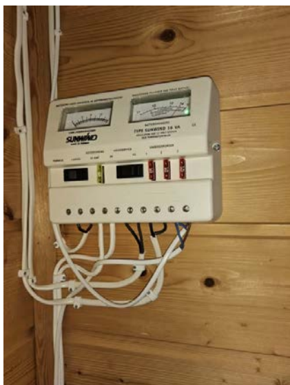
Bilde viser sikringspanel for solcelleanlegg.
