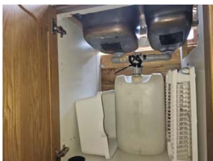
Bilde viser røropplegg under oppvaskkum på kjøkken.
