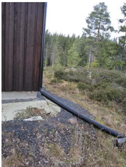
Bilde viser bortledning av takvann.
