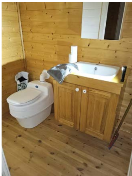
Bilde viser installasjoner på toalettrom.
