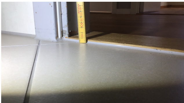
Liten oppkant under dør
