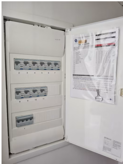
Sikringsskap er plassert i bod under trapp.
