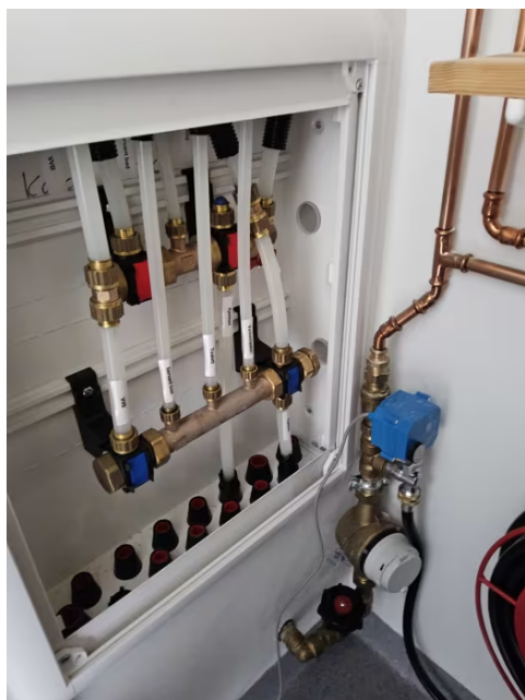
Fordelerskap for rør-i-rør og hovedstoppekran er plassert i bod under trapp.
