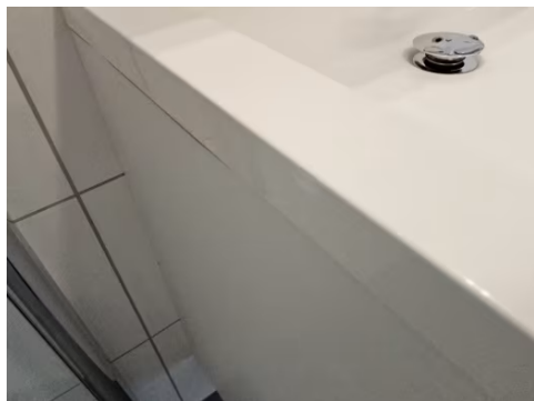
Liten skade på venstre side av servant.
