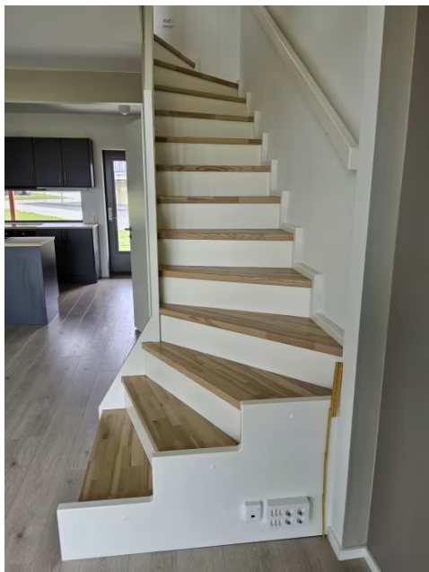
Nederste del av trappen mangler rekkverk.
