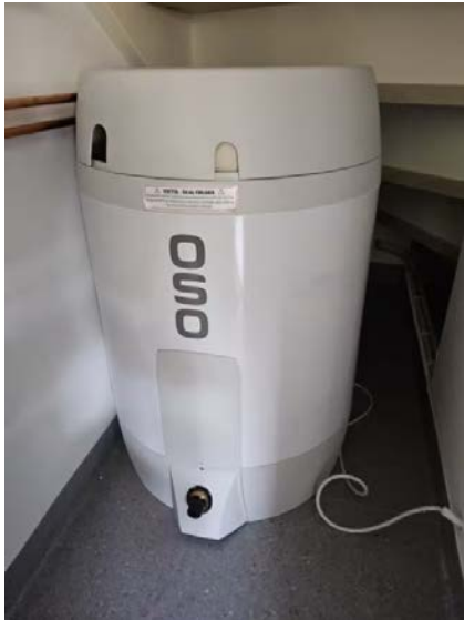
Varmtvannsbereder er plassert il bod under trapp.
