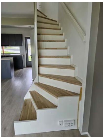
Nederste del av trappen mangler rekkverk.
