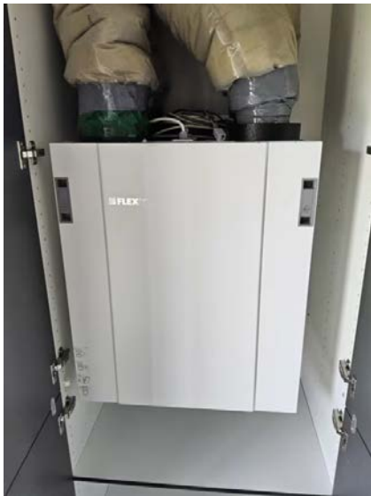
Ventilasjonsaggregat er plassert i kjøkkeninnredning.
