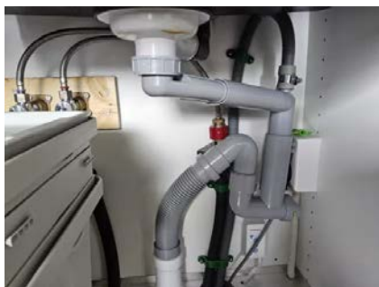
Synlige avløpsrør av plast i boligen.
