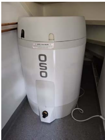
Varmtvannsbereder er plassert il bod under trapp.
