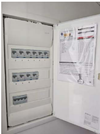
Sikringsskap er plassert i bod under trapp.
