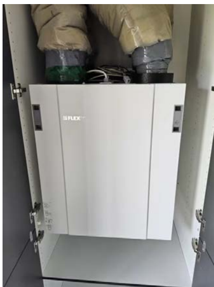
Ventilasjonsaggregat er plassert i kjøkkeninnredning.
