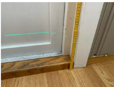
Måling på stue. 30mm skjevhet.
