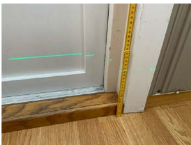
Måling på stue. 30mm skjevhet.
