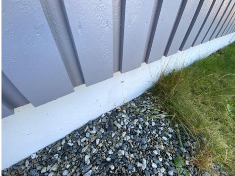
Stedvis riss i murpuss.
