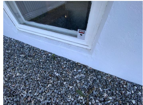
Stedvis riss i murpuss.
