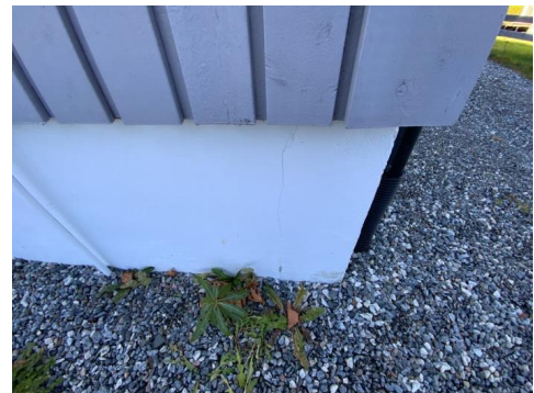
Stedvis riss i murpuss.
