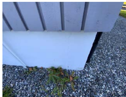
Stedvis riss i murpuss.
