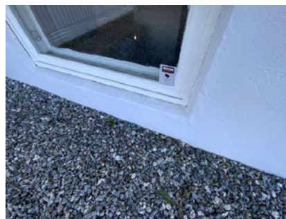
Stedvis riss i murpuss.
