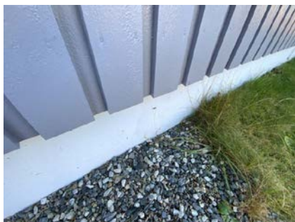
Stedvis riss i murpuss.
