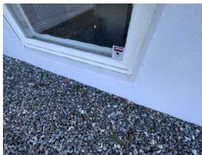
Stedvis riss i murpuss.
