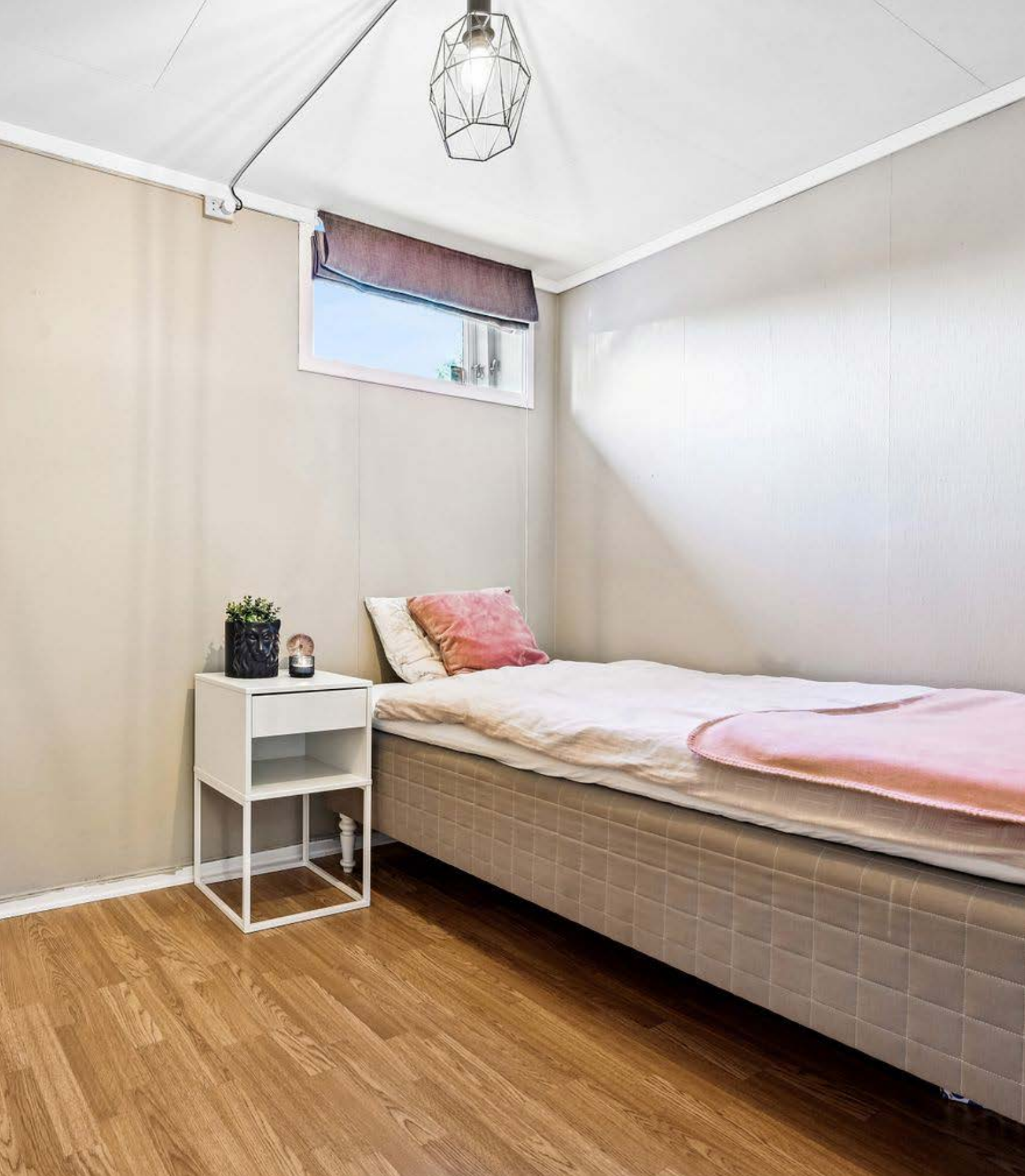
Innredet rom i kjeller (ikke godkjent for varig opphold eller bruksendret iht. originale byggetegninger).
