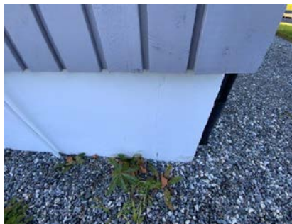
Stedvis riss i murpuss.
