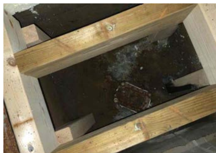
Stakepunkt på avløpsrør.
