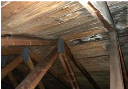
Synlige fukt flekker fra tiden før nytt taktekke ble lagt.
