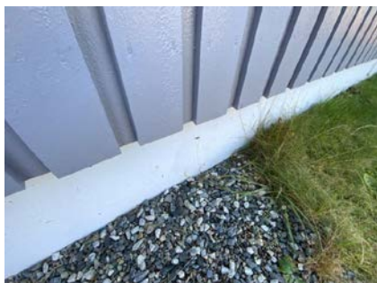
Stedvis riss i murpuss.
