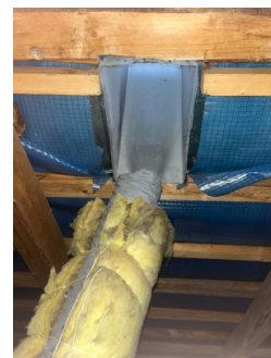
Ventilasjonsrør ledes ikke opp over tak.
