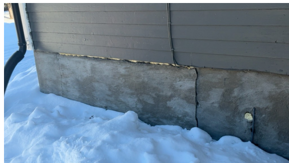
Eksempel på sprekk i grunnmur på tilbygg mot nord.
