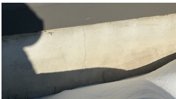
Eksempel på sprekk i overflate på grunnmur på opprinnelig del.
