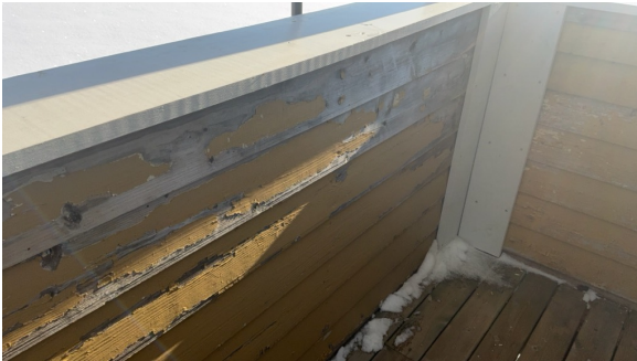
Eksempel på slitasje.
