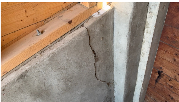
Sprekk i grunnmur på kjellernedgang
