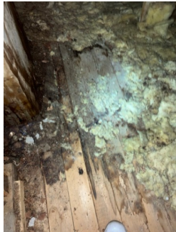
Tegn etter fuktighet på gulv rundt pipe.
