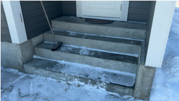
Noen sprekker i overflater på trapp
