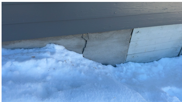
Eksempel på sprekk i grunnmur på tilbygg mot nord.
