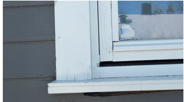
Eksempel på slitasje.
