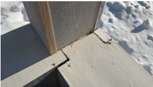
Eksempel på sprekk i toppbord.
