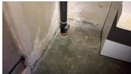
Eksempel på avskaling og saltutslag.
