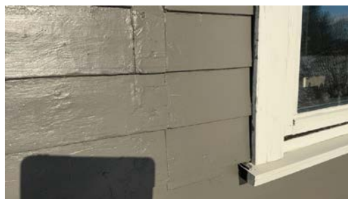
Eksempel på kledning som er skjøtet inn.
