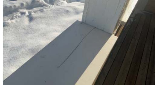
Eksempel på sprekk i toppbord.
