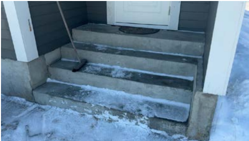
Noen sprekker i overflater på trapp
