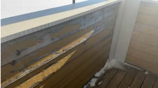
Eksempel på slitasje.
