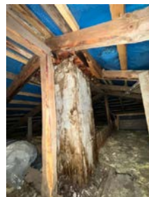
Rennemerker på og rundt pipe.
