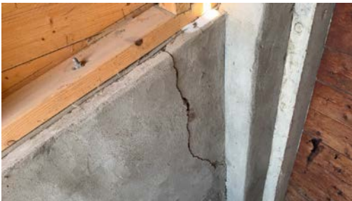
Sprekk i grunnmur på kjellernedgang
