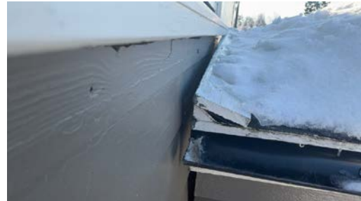
Det er ikke tett overgang mellom kjellernedgang og vegg
