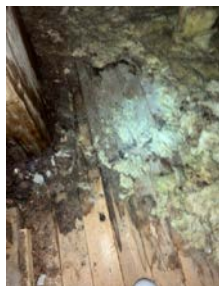
Tegn etter fuktighet på gulv rundt pipe.
