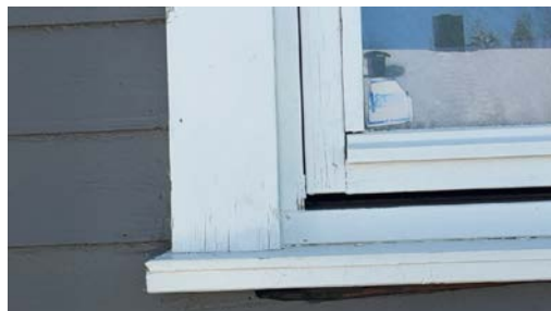
Eksempel på slitasje.
