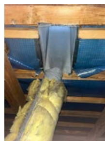
Ventilasjonsrør ledes ikke opp over tak.
