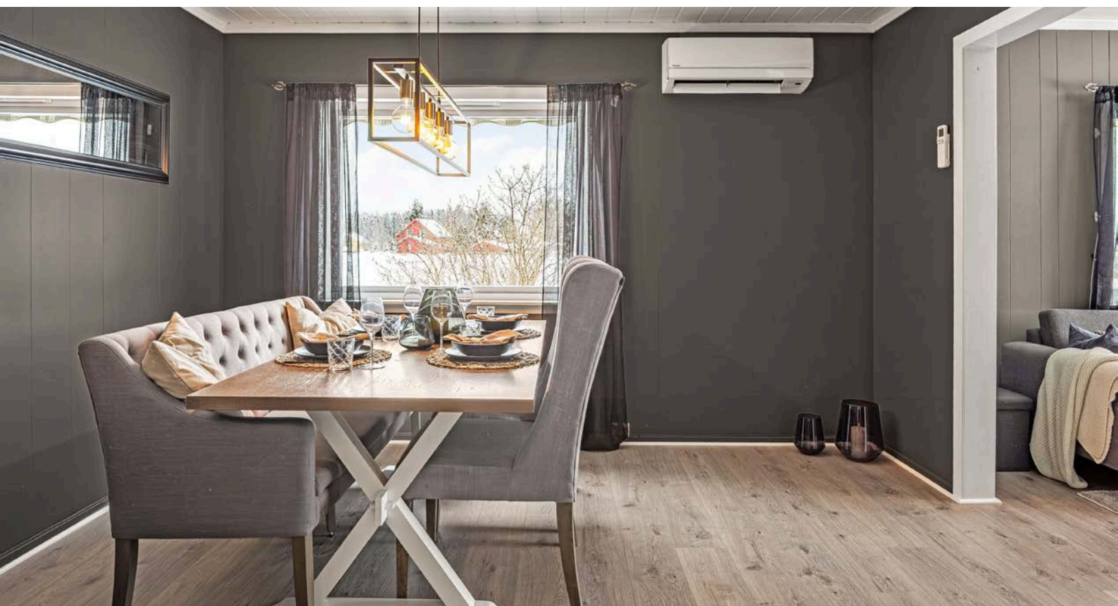
Varmepumpe fra 2019 fint plassert i rommet.
