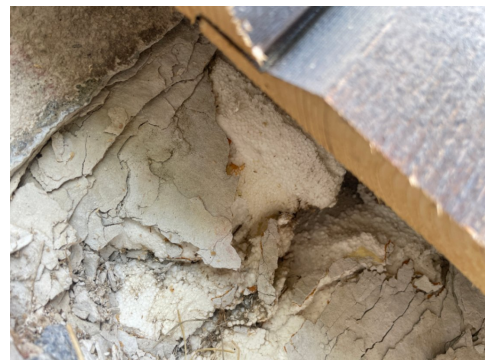
Skader på ringmursplater/synlig isopor.
