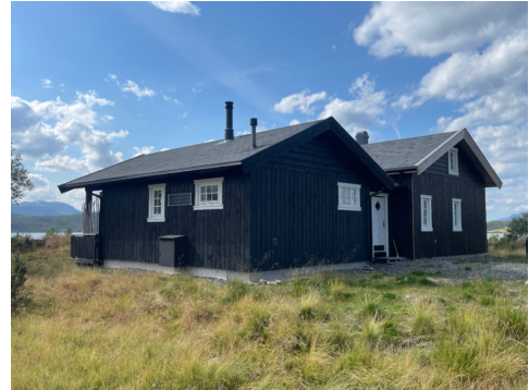
Manglende takstige til begge piper.
