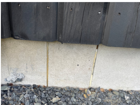
Avvik på skjøter mellom ringmur
