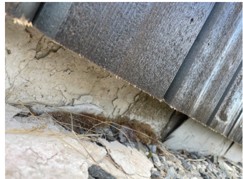
Skader på ringmursplater
