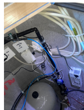
Rommet har dårlig ventilering.
