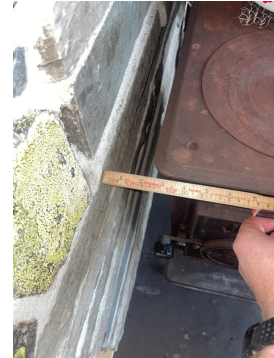
Avstand til brannmur under 10 cm
