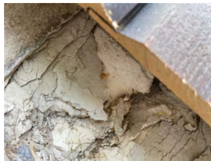
Skader på ringmursplater/synlig isopor.
