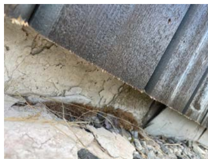
Skader på ringmursplater
