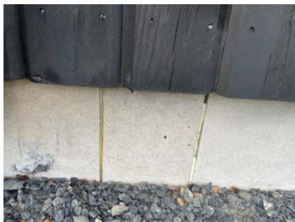
Avvik på skjøter mellom ringmur
