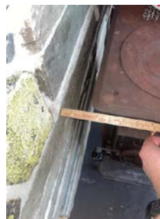
Avstand til brannmur under 10 cm
