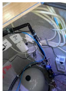
Rommet har dårlig ventilering.
