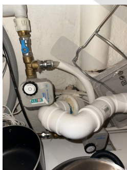
Røropplegg på kjøkken med Waterguard
