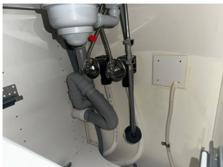
Røropplegg i kjøkkenbenk
