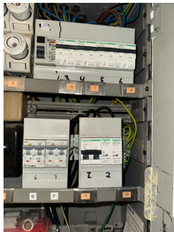
Sikringsskap med automatsikringer.
